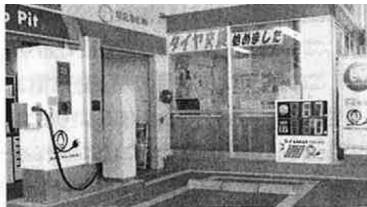
図 17. SS に設置された EV 用急速充電装置(垣見油化)
